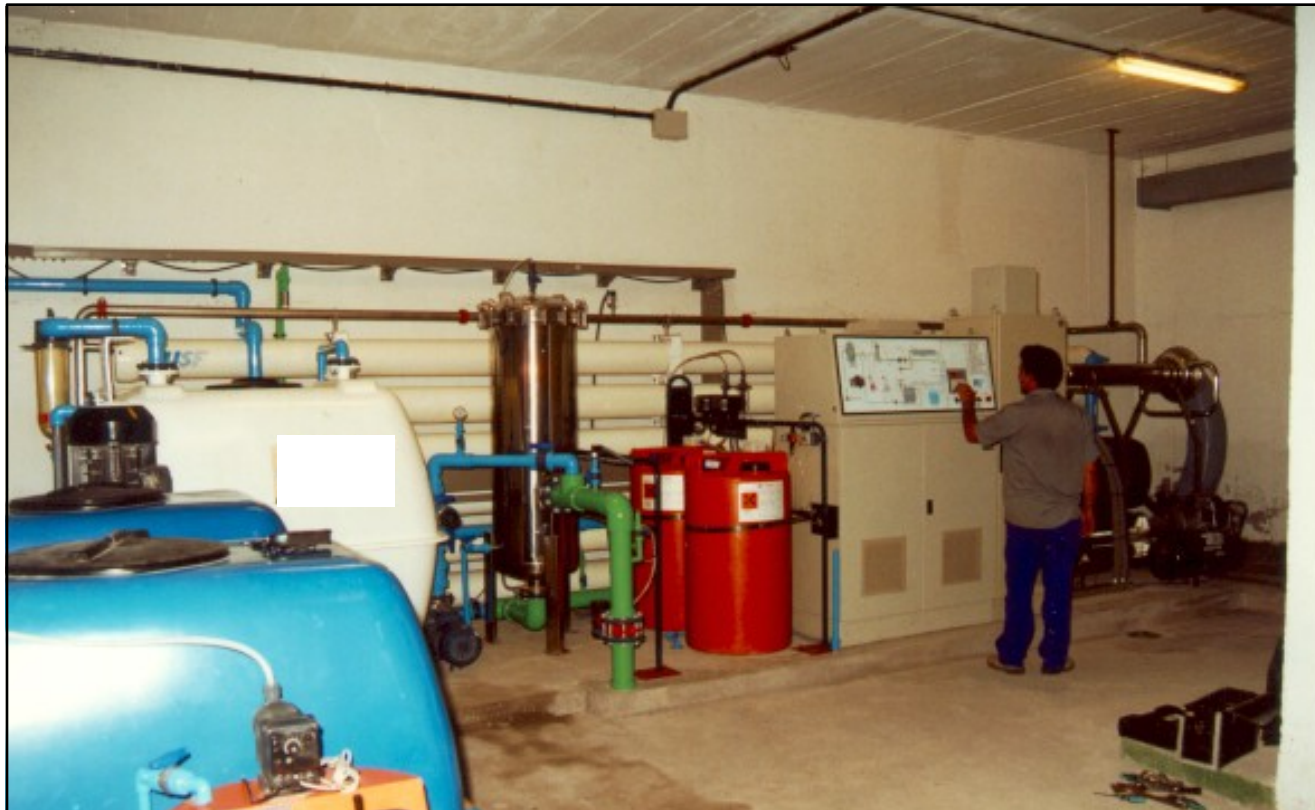
Vista parcial de la Planta de Ósmosis Inversa instalada en el Hotel Bahía del Duque (Tenerife - Islas Canarias)
