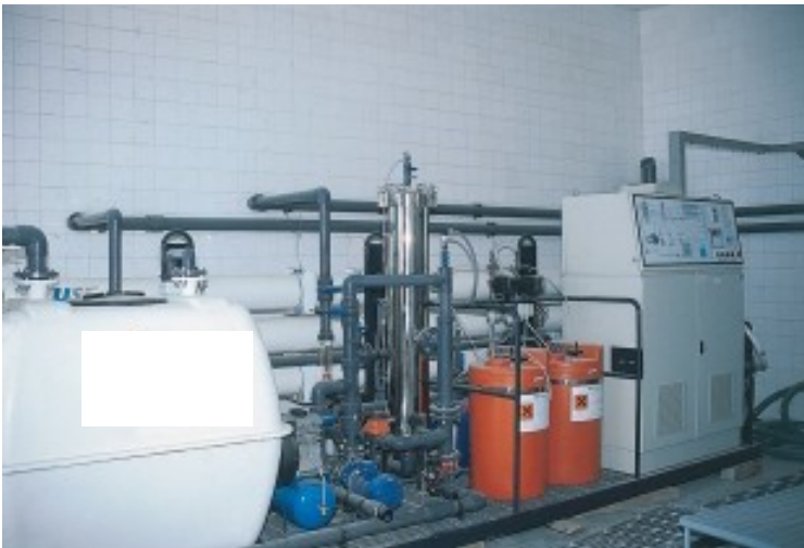
Vista Parcial de la planta de Ósmosis Inversa instaladas que alimenta fuentes públicas en la Ciudad de Vergel (Alicante - España)
